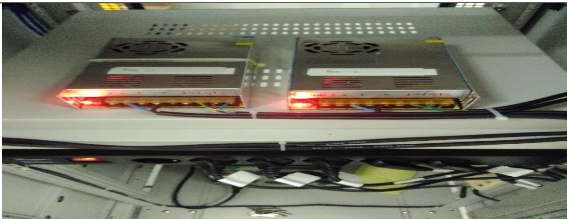
INSTALASI RECTIFIER DI SERVER SETDA
