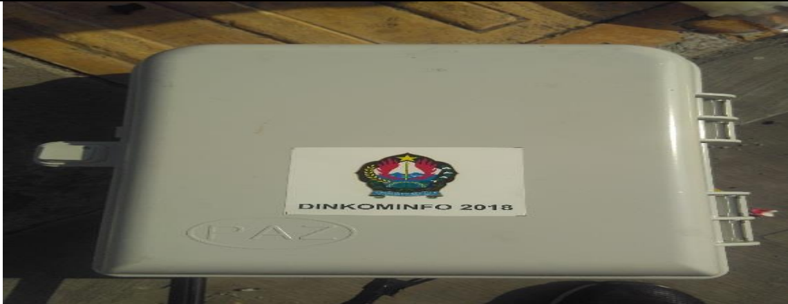
INSTALASI ODP SPLITER 2:8
